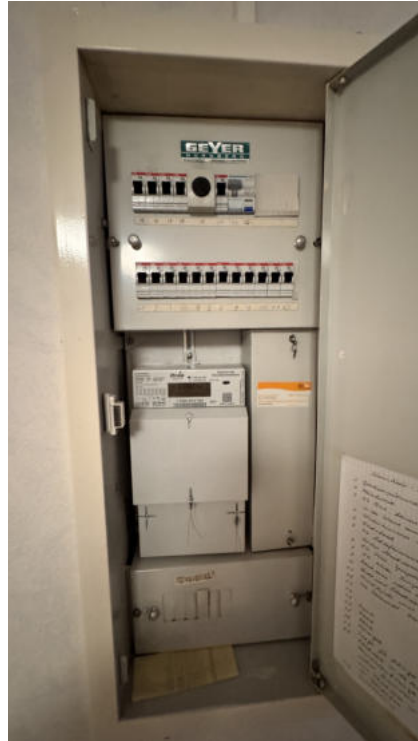
Schaltkasten Elektrik UG
